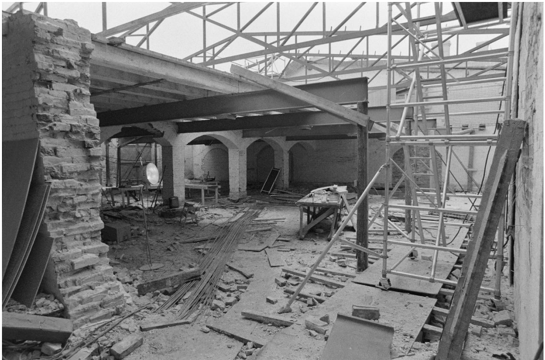
Vanhan välipohjan primääripalkkeina toimivat teräspalkit, joiden päällä olivat puiset sekundääripalkit ja toisen kerroksen lattiaudoitus. Kuvassa näkyy myös keskellä rakennusta sijainnut, pitkittäissuuntainen kaariaukkomuuri. Kuva Satakunnan museo, kuvaaja Jalo Porkkala vuonna 1980.
