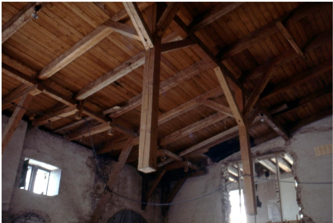
Dramaattinen kuva siitä, miten vesikaton puurakenteita kantavat pilarit ovat jääneet tyhjän päälle, kun välipohja on purettu. Kuva Gullichsen-Vormala Ky:n arkisto, kuva todennäköisesti vuodelta 1980.
