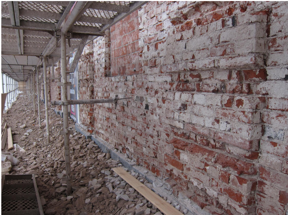
Julkisivujen rappaus uusittiin täysin ja tiiliäkin todennäköisesti jouduttiin uusimaan paikallisesti. Kuva Liisa Nummelin, Satakunnan museo.
